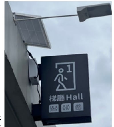
圖2. 太陽能儲能輔助LED燈箱實績
